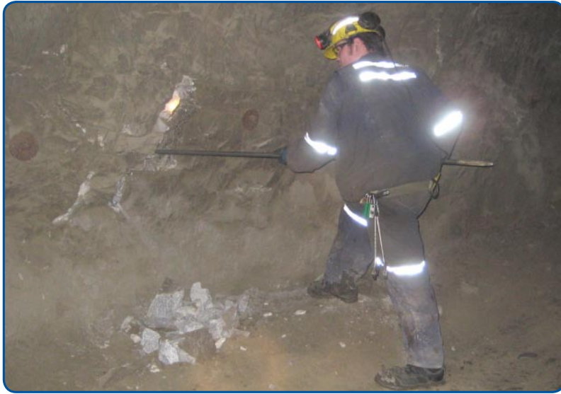
Figure 1 : Purge du mur d'une galerie
