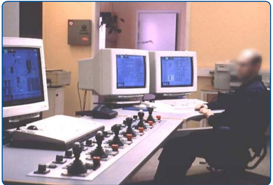
Figure 2 : Exemple d'une salle de commandes opérationnelles dotée de l'interface homme-machine
