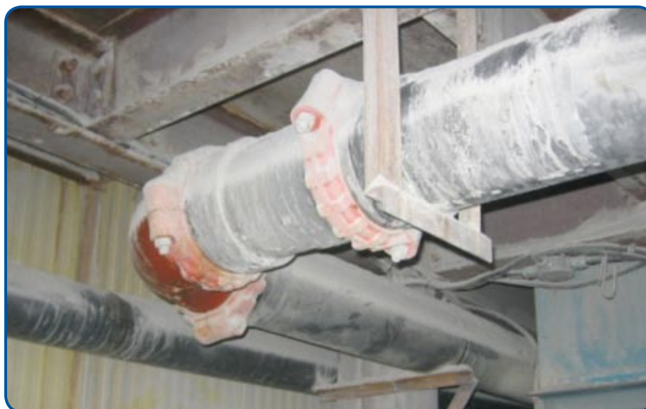
Figure 2 : Les travailleurs peuvent remplacer les systèmes de canalisation nécessitant d'utiliser des échelles ou d'atteindre des endroits surélevés.
